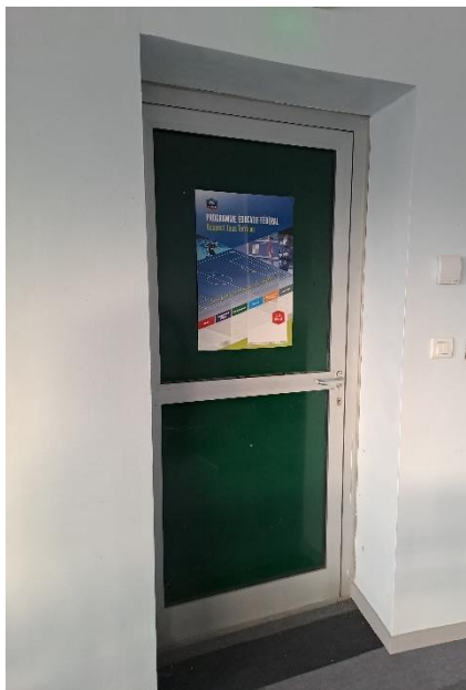
Photo intérieure issue de secours
